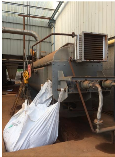
F14 污泥干化处理
