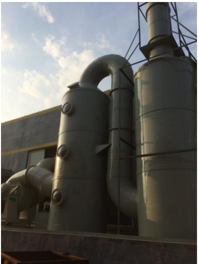
F11 废气处理设施改造
