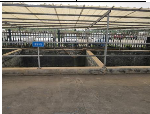
应急事故水池
